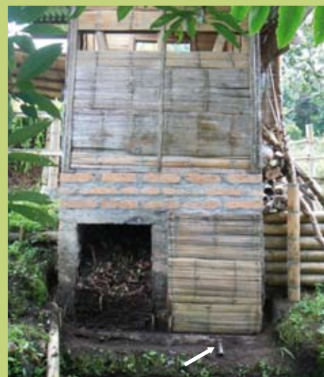
Parte trasera donde se encuentran las cámaras de almacenamiento y el tubo de drenaje de exceso de líquidos
