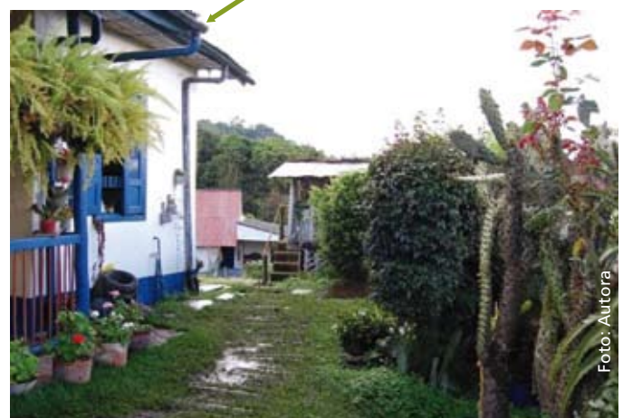
Canaleta y bajante para recolectar agua de lluvia
