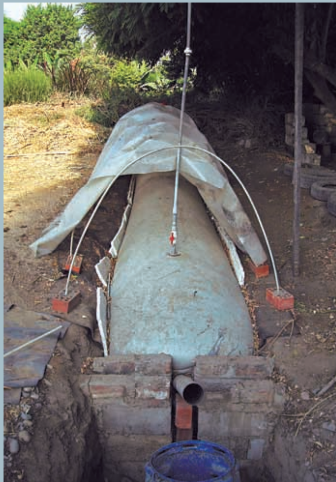
Biodigestor de geomembrana 📷 T. Gianella
