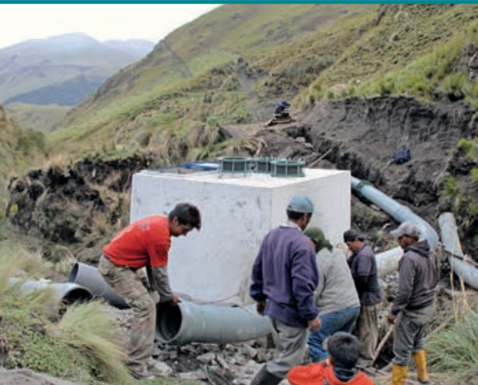
Trabajo comunal para la reparación del sistema de riego, San Isidro, Ecuador. 📷 Tristan Partridge
