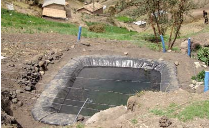
Reservorio con geomembrana
